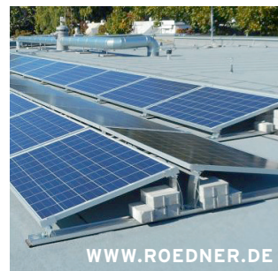
Kita 11 Mörfelden-Walldorf: Die 10 kWp PV-Anlage passt wunderbar zu dem nachhaltigen Bau- und Energiekonzept.
